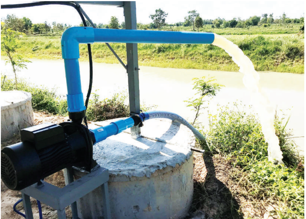
ปั๊มหอยโข่งสูบน้ำจากสระ
