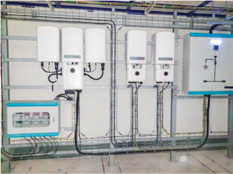
อินเวอร์เตอร์ออนกริดในโรงงาน
